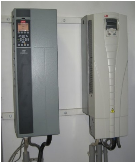
Fig. 1. Convertoarele de tensiune și frecvență din stația de epurare: stânga - Danfoss, dreapta - ABB.
